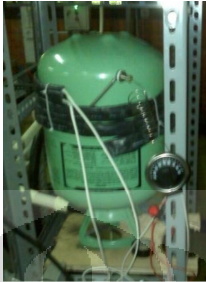
Gambar 3.3 Heater yang dipasang pada tabung refrigerant .
