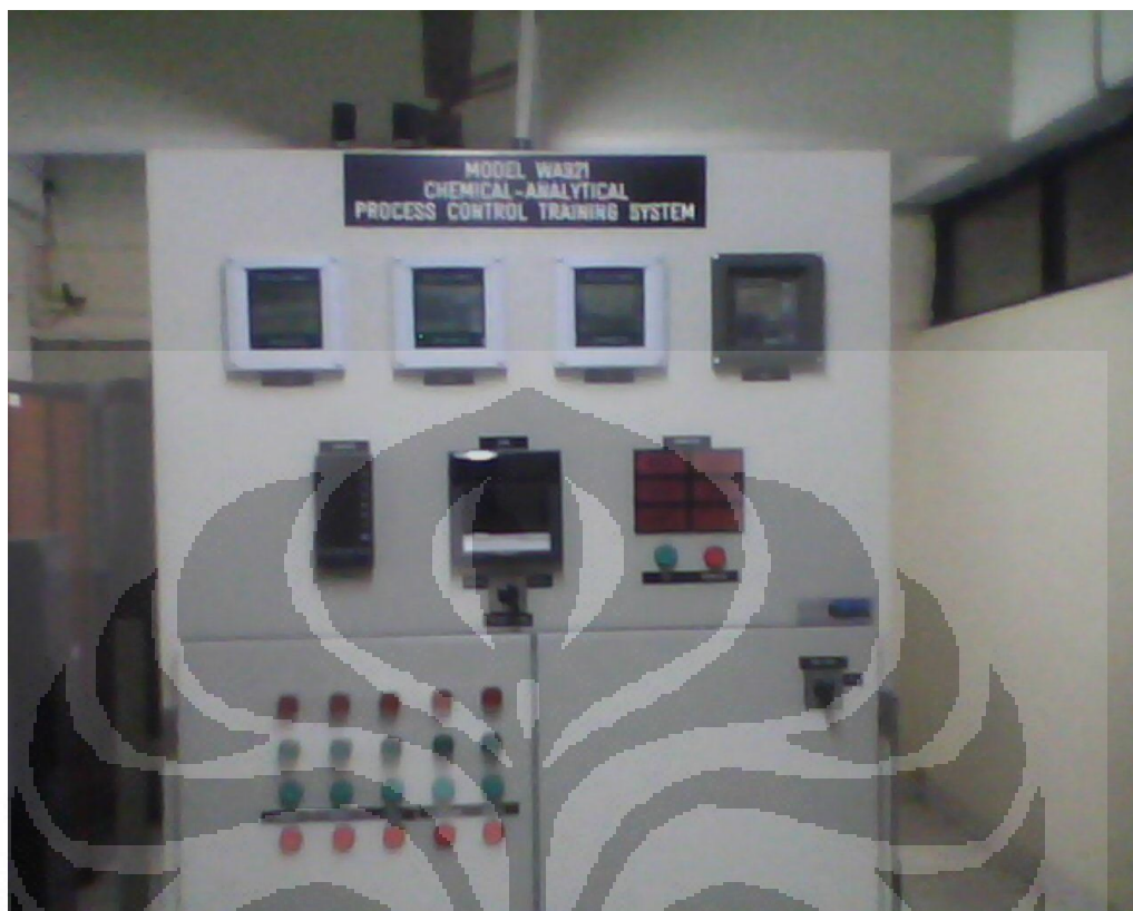
Gambar Depan Unit Mini Plant WA921
