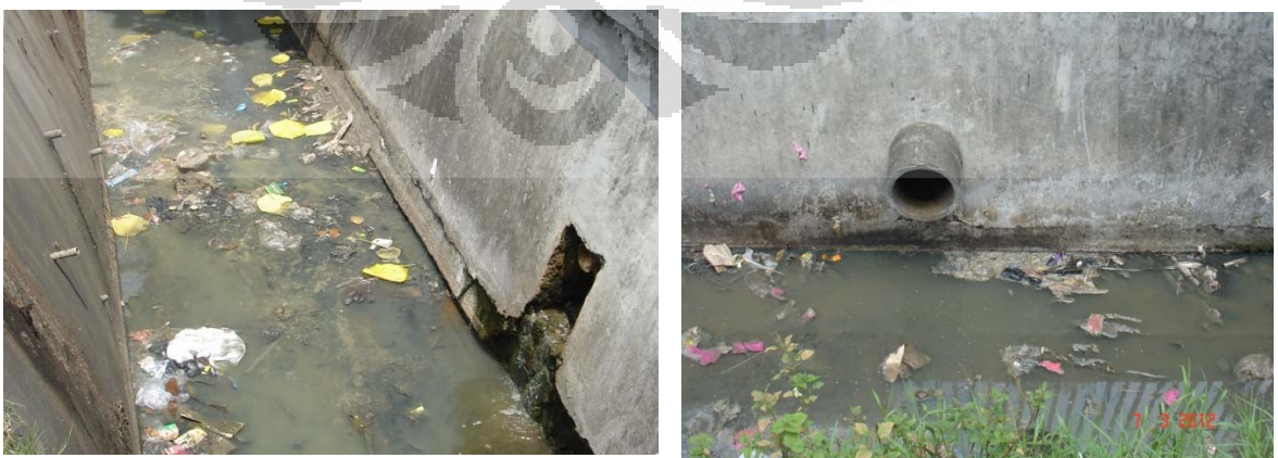
Gambar 4.4 Saluran Kota Tempat Pembuangan Limbah Gedung Pertamina MTC
