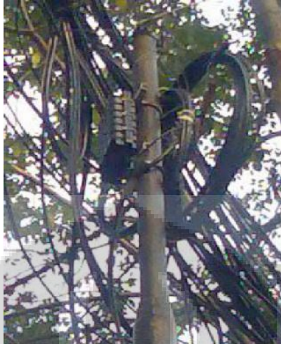
Gambar 3.6 Tiang Pancang di infrastruktur FTTH
