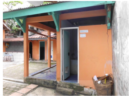
Foto 8: Toilet Umum di Jalan Pantai Barat (Januari, 2012)
