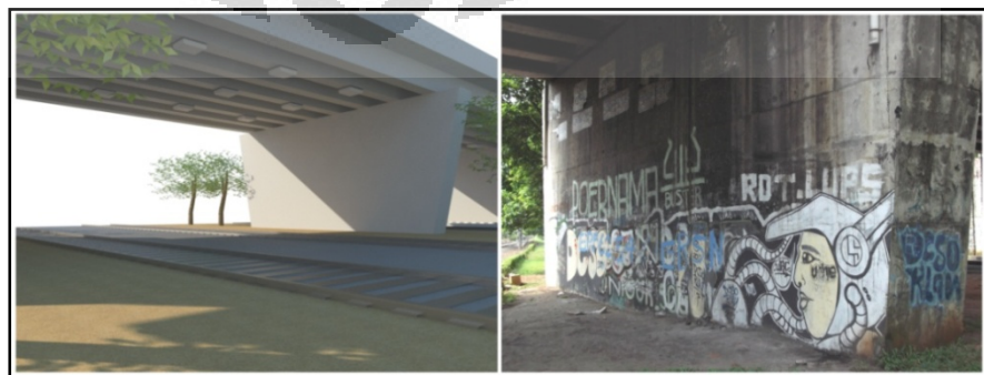
Gambar 4.4. Ilustrasi Kondisi Sebelum dan Sesudah Dinding Kolom Jalan Layang UI Mengusam
