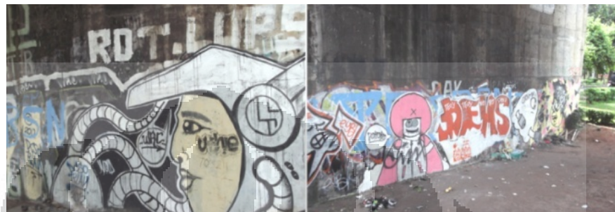
Gambar 4.6. Vandalisme di Kolom Jalan Layang UI
