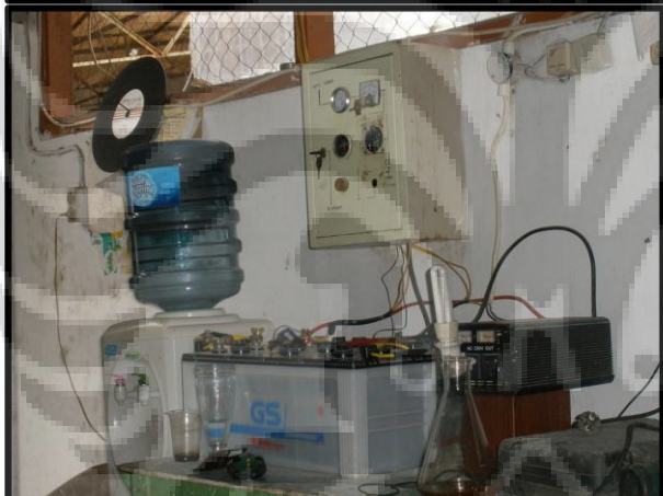
Komponen Panel Listrik
