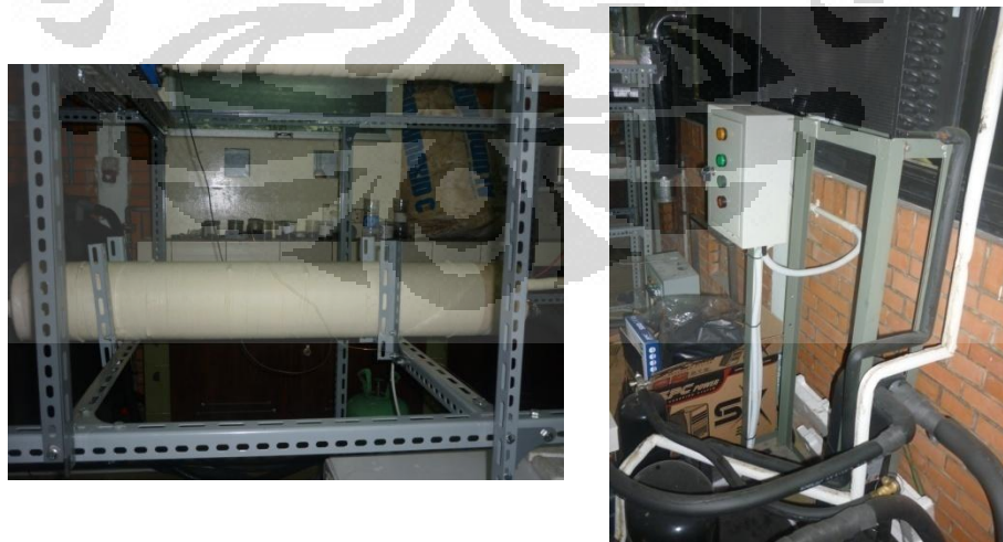
Gambar 3.4. Condensing Unit 3 Pk
