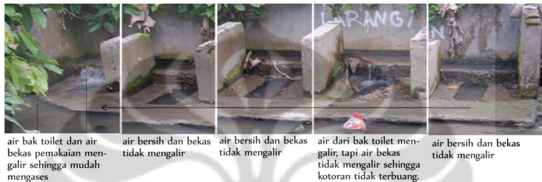
Gambar 3.18 Aliran air yang melimpah dari bak toilet
