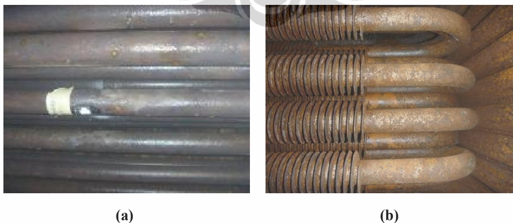
Gambar 4.16 Perbandingan Korosi pada Outer Side : a). Secondary Superheater ; b). Economiser
