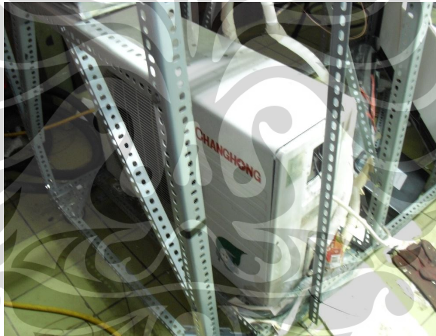
Gambar 3.7 Foto Condensing Unit
