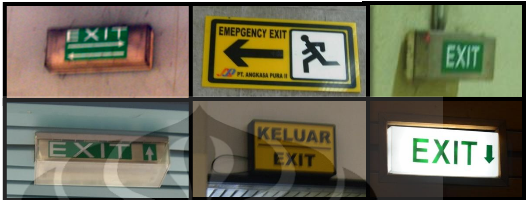
Gambar 6.20: Jenis-jenis petunjuk jalan keluar yang ada di terminal 2
