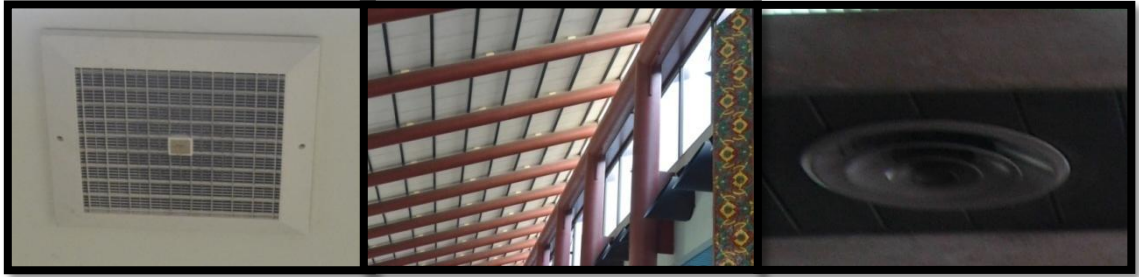
Gambar 6.24: Exhaust fan dan jendela pengendali asap darurat di terminal 2
