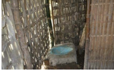
Konstruksi bangunan WC belum permanen masih menggunakan bilik.
