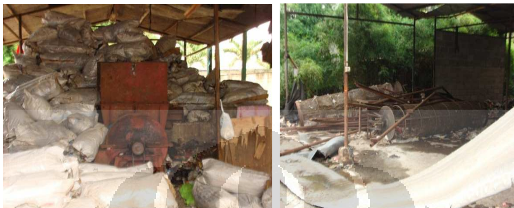
Gambar 4.5 Mesin Crusher dan Screen yang Rusak dan Tertutupi Sampah
