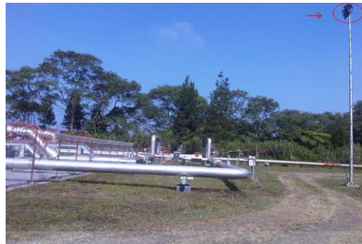
Gambar 5.41 Perangkat Penerangan Sebagai Pengawasan Mekanis di Sumur
