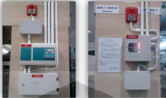
Gambar 6.6 Instalasi Pemadam Khusus (Fire Gas) di Perpustakaan Pusat Universitas Indonesia
