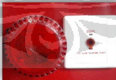
Gambar 6.23 Fire Alarm Telephone Socket Gedung Perpustakaan Pusat Universitas Indonesia
