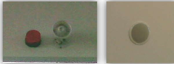
Gambar 6.24 Sarana Tata Suara di Setiap Ruangan Pada Gedung Perpustakaan Pusat Universitas Indonesia
