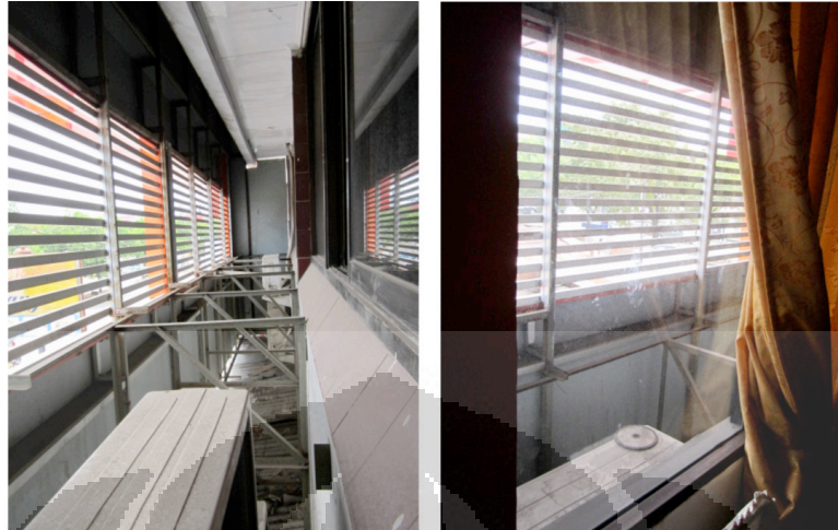
Gambar 23 . Mesin outdoor AC pada hotel
