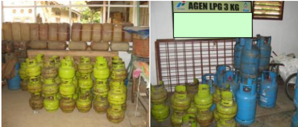
Gambar 5.39. Ventilasi pada Ruang Penyimpanan LPG yang Tertutup
