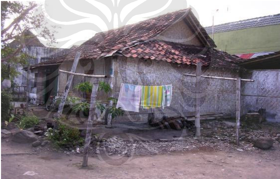
Gambar 9. Rumah berdinding bambu sebagai citra kekumuhan dan kemiskinan tahun 2003 (Dokumentasi FMCU)
