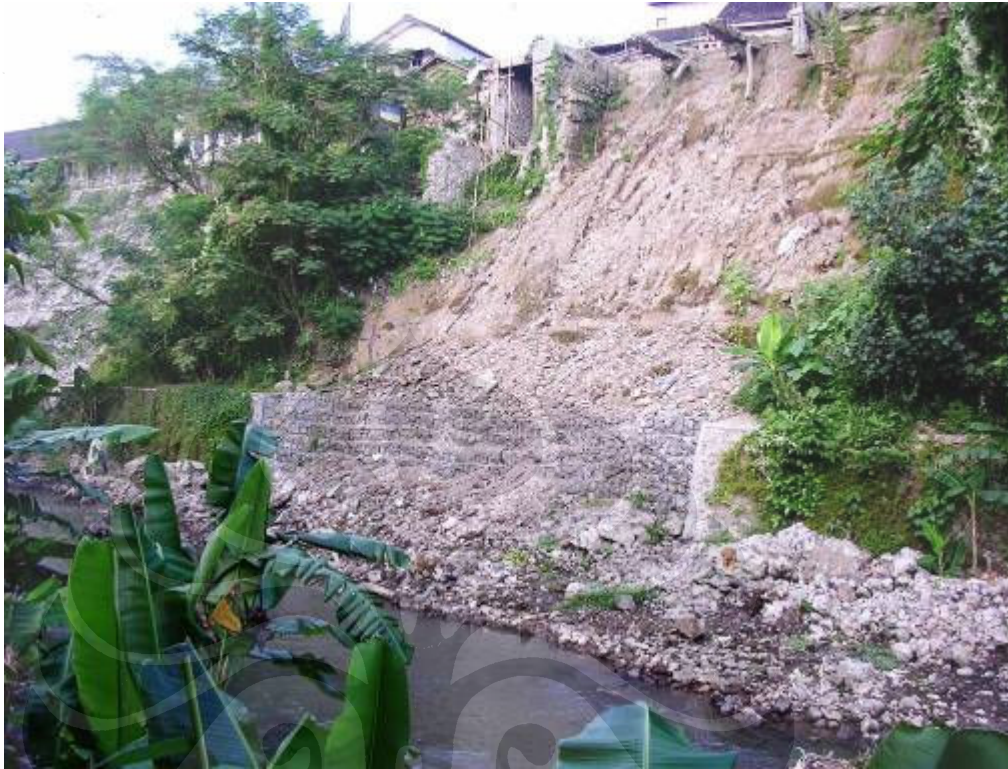
Gambar 12. Talud yang rentan terhadap longsor tahun 2008
