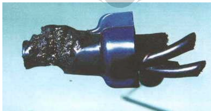
Gambar 3.5 : Sambungan Kabel menggunakan las-dop dan terbakar
