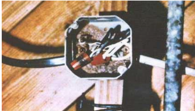
Gambar 3.3 : Sambungan kabel didalam T-doo
