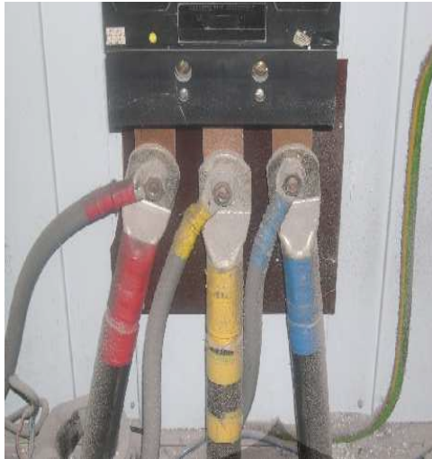
Gambar 1.2 : Sambungan kabel pada panel listrik
