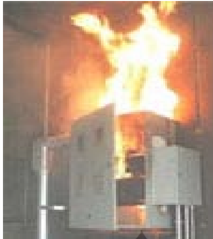
Gambar 1.5 : Terbakarnya kabel dalam panel berdampak terbakarnya panel listrik
