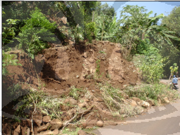
Longsoran akibat gempabumi di desa Wonolelo, Kecamatan Plered, Bantul. *
