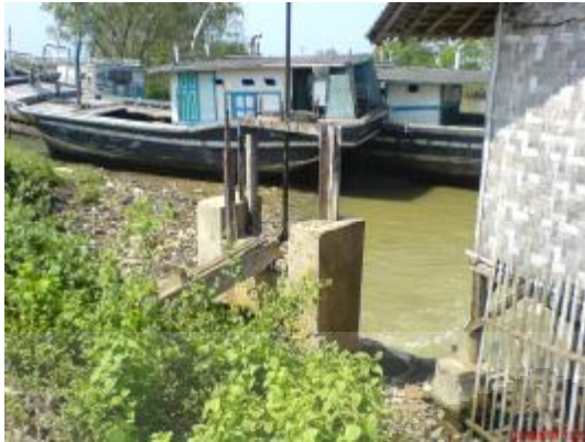
Pintu air saluran Kalimalang – Ci Pasilian
