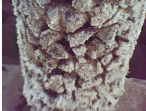
Gambar 4.12. Beton Mengeluarkan Serbuk Natrium Karbonat
