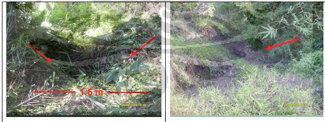
Gambar 4.2 Erosi parit di Desa Padawaras Gambar 4.3 Erosi tebing di Desa Padawaras Sumber: dokumentasi pribadi Rupaidah, 26 Mei 2008 Sumber: dokumentasi pribadi Rupaidah, 26 Mei 2008
