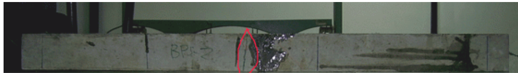
(b) Gambar 4.2.11. (a) Sketsa lokasi retak dan (b) Retak benda uji BPS-2 pada pengujian awal yang sudah diperbaiki
