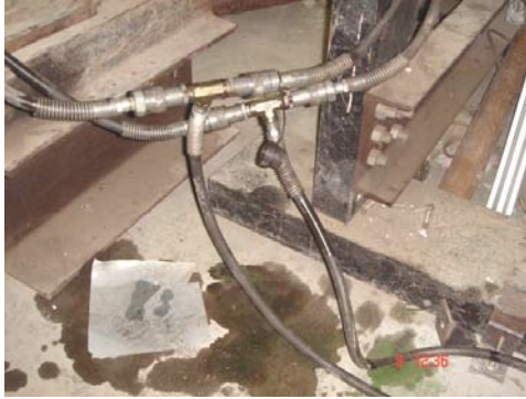
Gambar 4.14 Kebocoran Pelumas pada Actuator
